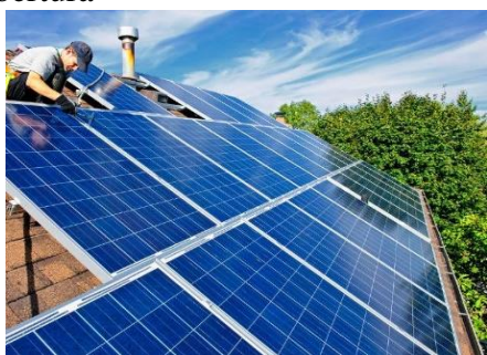
Figura 01 – Painéis fotovoltaicos na cobertura
